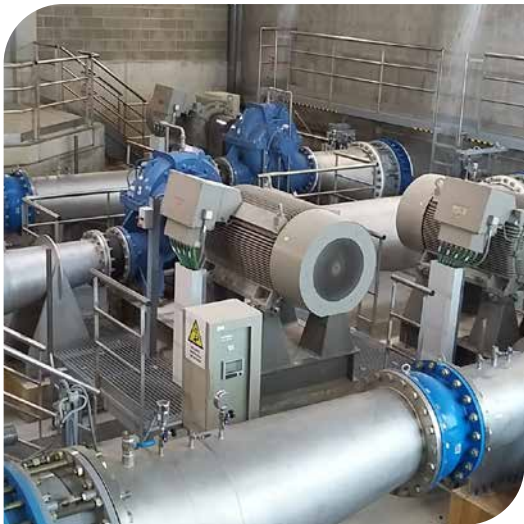
STATION DE POMPAGE ASSAINISSEMENT ALLEMAGNE Clapet RSK
